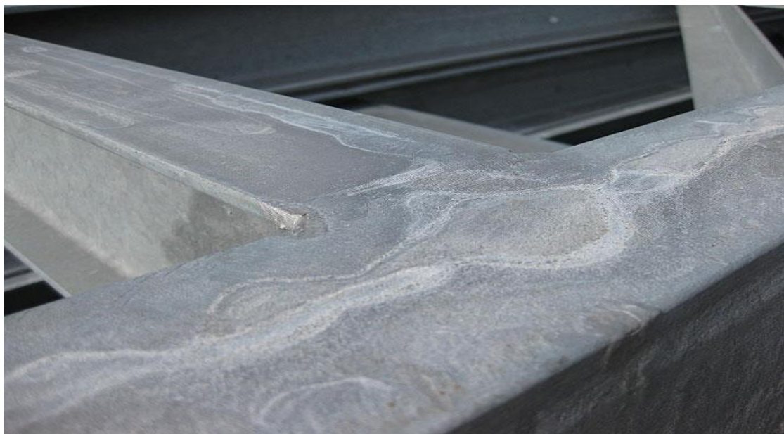
Obr. 1.3 Biela korózia na konštrukcii.
