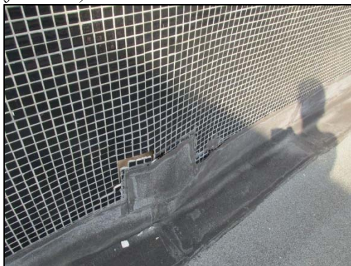
Obr. 25: Napojení asfaltového pásu na stěnu, degradace keramického obkladu (foto autor)
