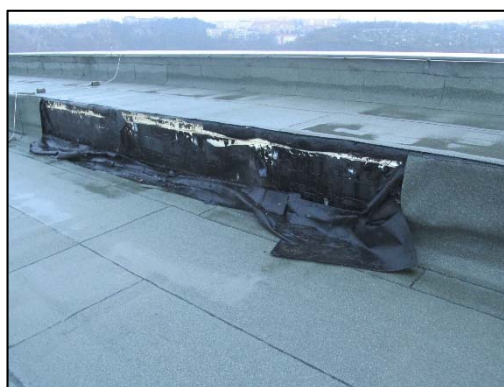
Obr. 22: Održení asfaltového podkladu od povrchu (foto autor)
