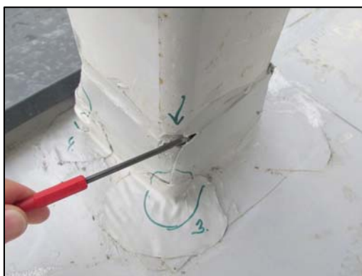
Obr. 7: Zkouška jehlou (foto autor)
