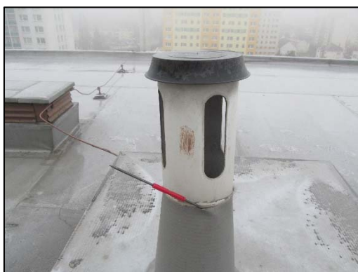
Obr. 13: Netěsnost v opracování prostupu (foto autor)
