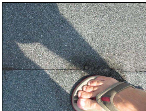
Obr. 24: Vadné spojení asfaltových pásů (foto autor)
