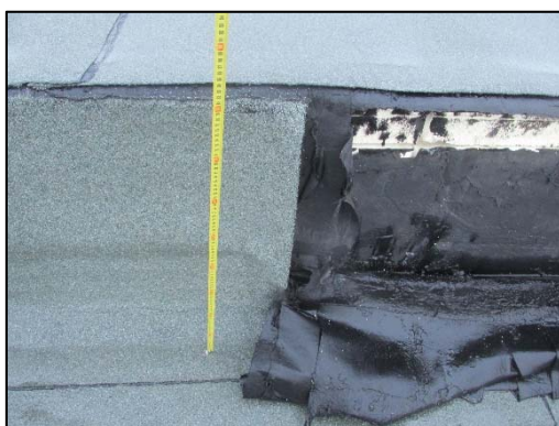
Obr. 21: Održení asfaltového podkladu od povrchu (foto autor)
