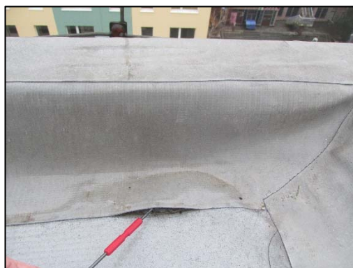
Obr. 12: Netěsný spoj hydroizolační fólie (foto autor)
