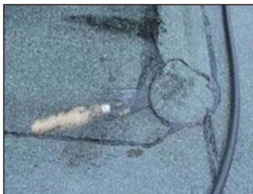
Obr. 20: Nesvařený spoj asfaltových pásů (foto autor)
