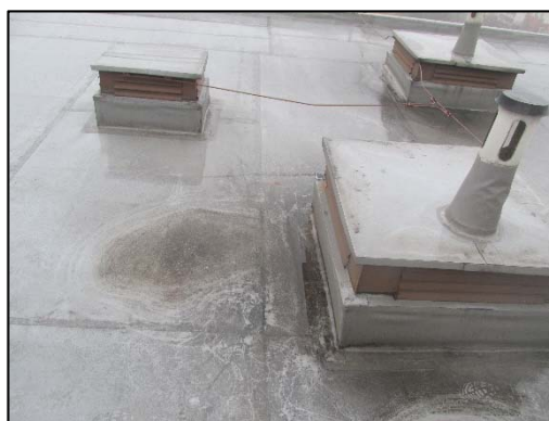
Obr. 14: Mapy po kalužích kolem komor vzduchotechniky (foto autor)
