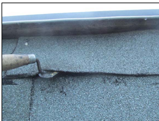
Obr. 19: Netěsný spoj asfaltových pásů (foto autor)
