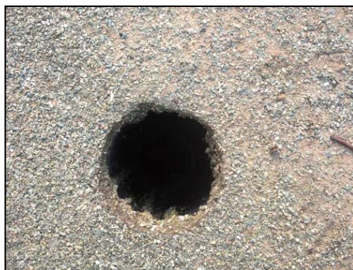
Obr. 28: Vyčištěný vtok bez ochranného koše (foto autor)
