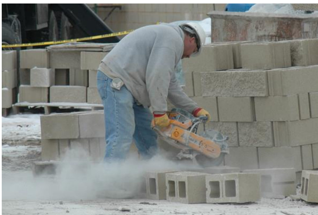
Obrázek 11 - Příklad vzniku nadměrného prášení na stavbě
