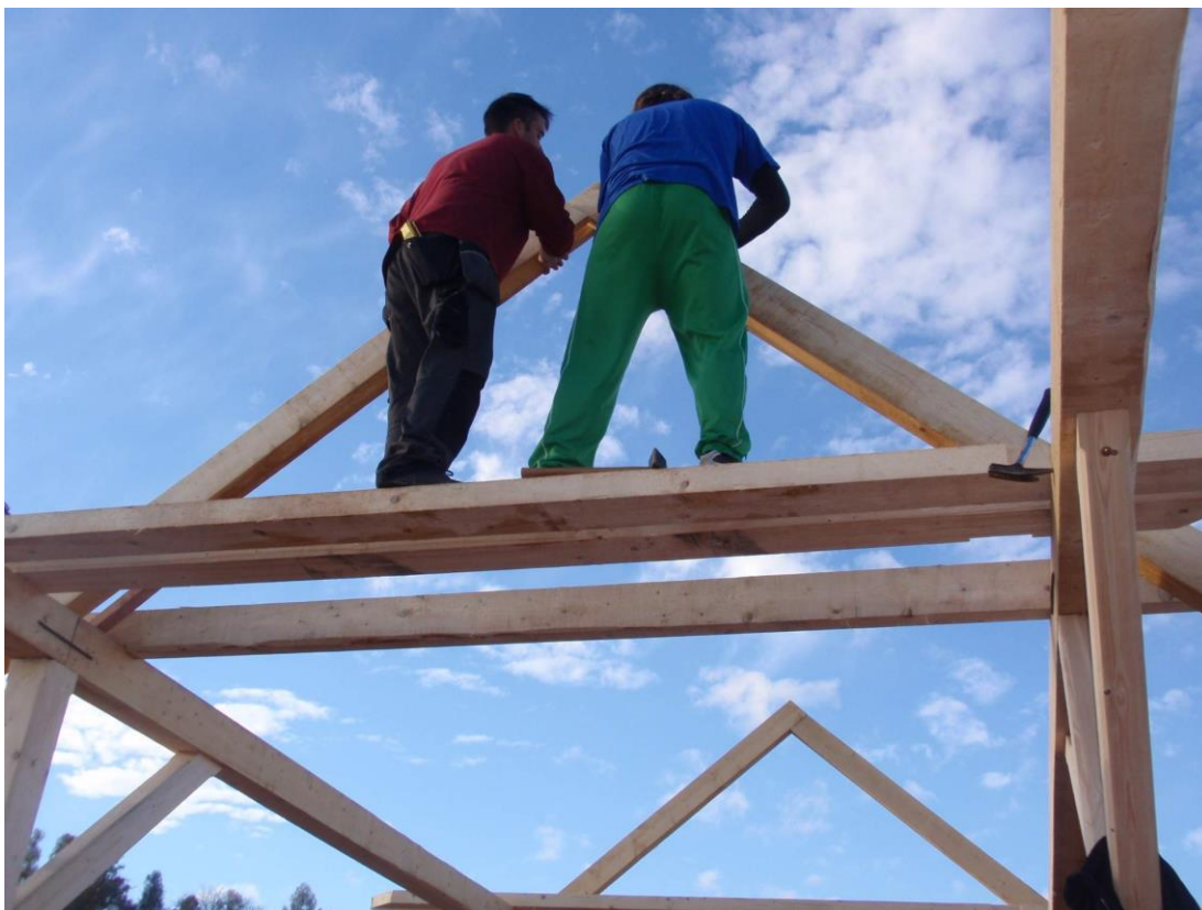
Obrázek 7 - Špatné zabezpečení pracovníků při práci ve výškách
