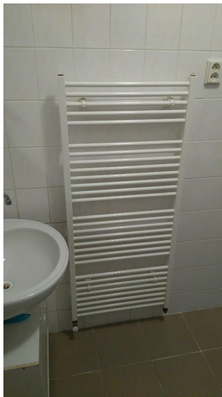
obr. 4 - Trubkové otopné těleso
