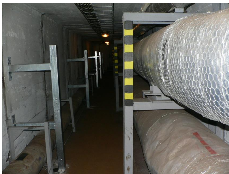
Obr. 22 – Ukázka kolektoru areálu FN Motol
