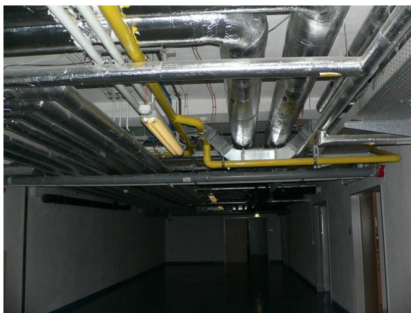
Obr. 24 – Ukázka technické chodby areálu FN Motol
