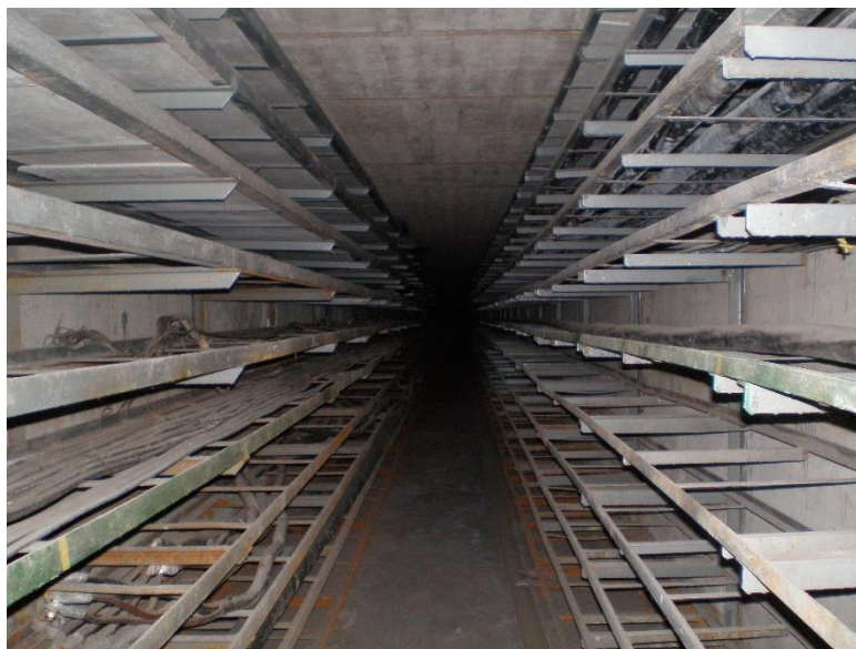
Obr. 17 – Pohled do ŽB hloubeného kolektoru – vedení silových kabelů NN a vodovodu z PE trubek
