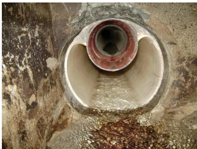
Obr. 10 – Specifický rukávový relining „Two in one technique Enters the NO Dig World“, příklad, Švédsko, 2007
