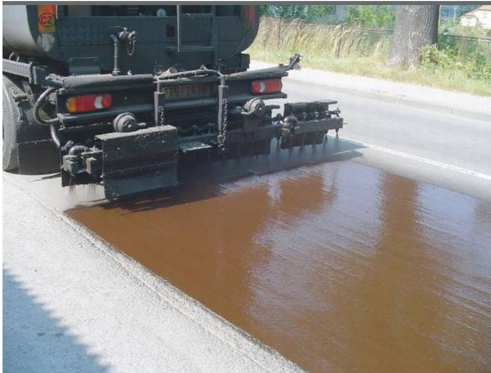
Obrázek 8 - Povrchový asfaltový nátěr [22]
