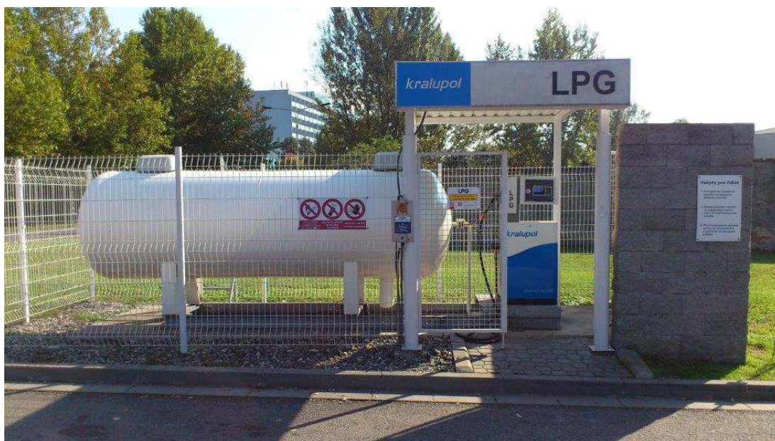
Obr. 6 Nadzemní zásobník LPG [17]
