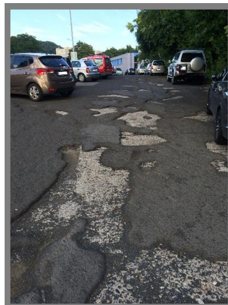
Obr. 15: Povrch vozovky na parkovišti v ulici Malátova 20
