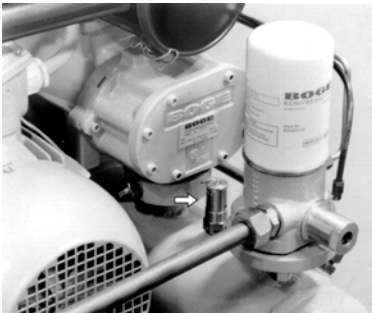
Bild 3.42: Sicherheitsventil am Schraubenkompressor
