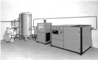
Bild 8.8 : Kompressorstation mit Schraubenkompressor, Kälte-Drucklufttrockner, Druckluftbehälter und Filtersystem
