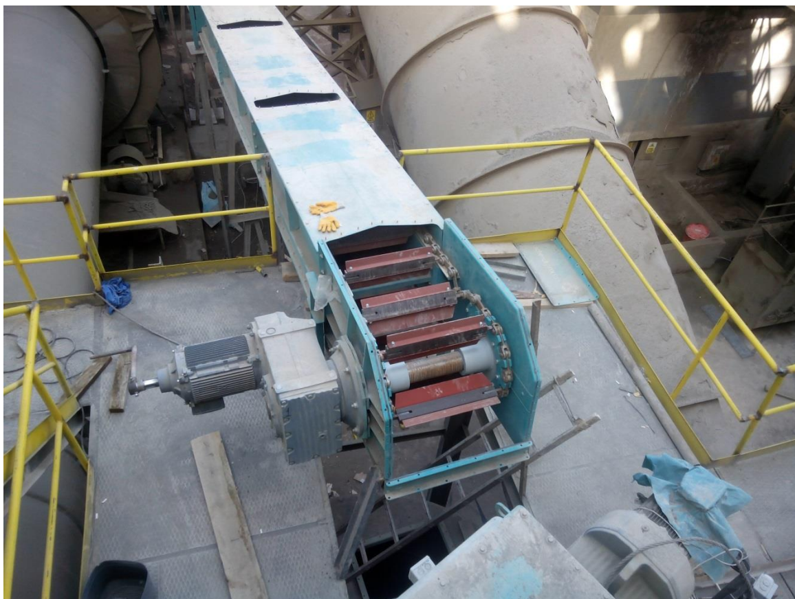
Obr. 17. Pohled na poháněcí stanici dopravníku [6]
