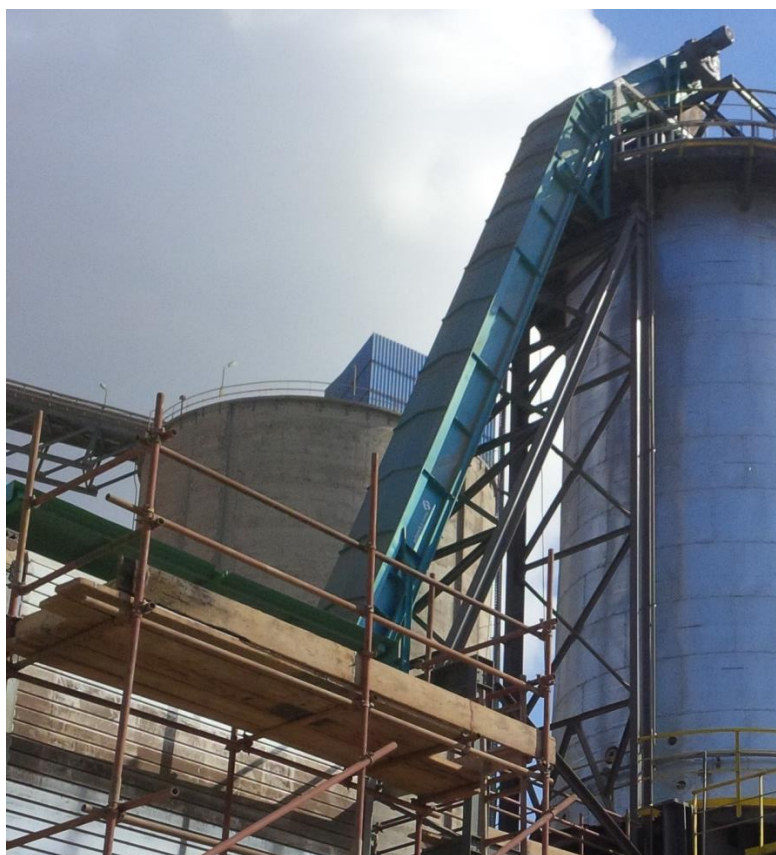
Obr. 16. Dopravník z příjmové stanice do sila [6]
