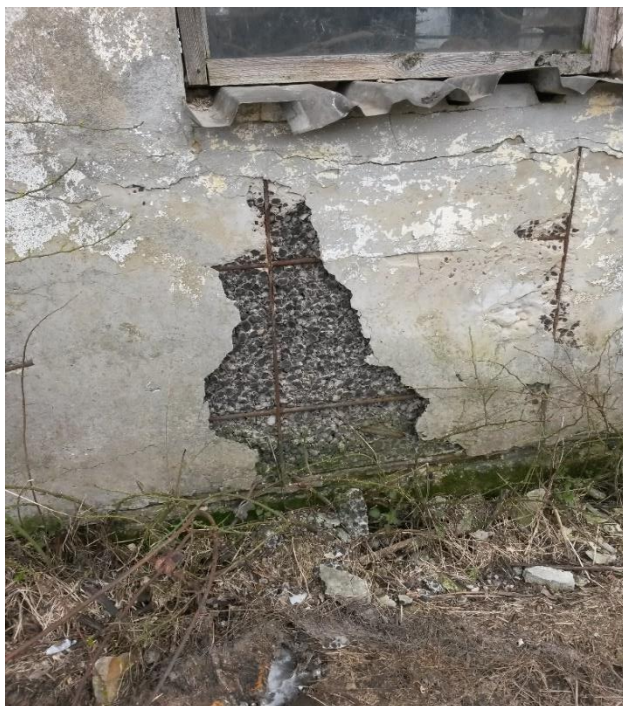
Obr. 22: Porucha č.4 – Obnažená obvodová výztuž
