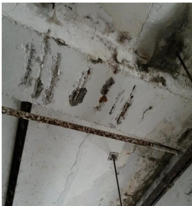
Obr. 26: Porucha č.8 – Obnažená výztuž průvlaku
