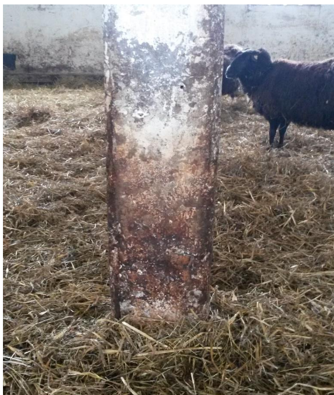
Obr. 24: Porucha č.6 – Obnažená obvodová nosného sloupu
