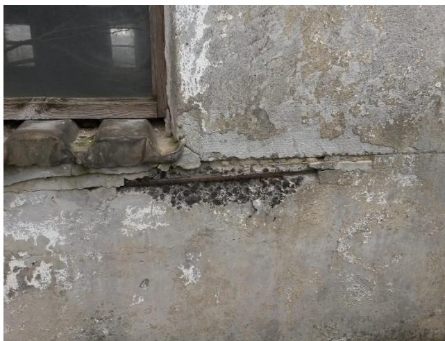
Obr. 19: Porucha č.1 – Obnažená obvodová výztuž
