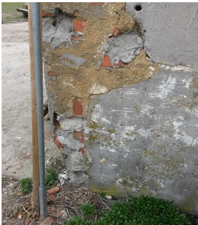
Obr. 21: Porucha č.3 – Rozpadající se obvodové zdivo
