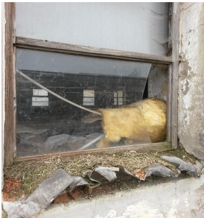
Obr. 23: Porucha č.5 – Rozbitá skleněná výplň u stájových oken
