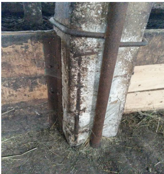
Obr. 25: Porucha č.7 – Obnažená výztuž nosného sloupu
