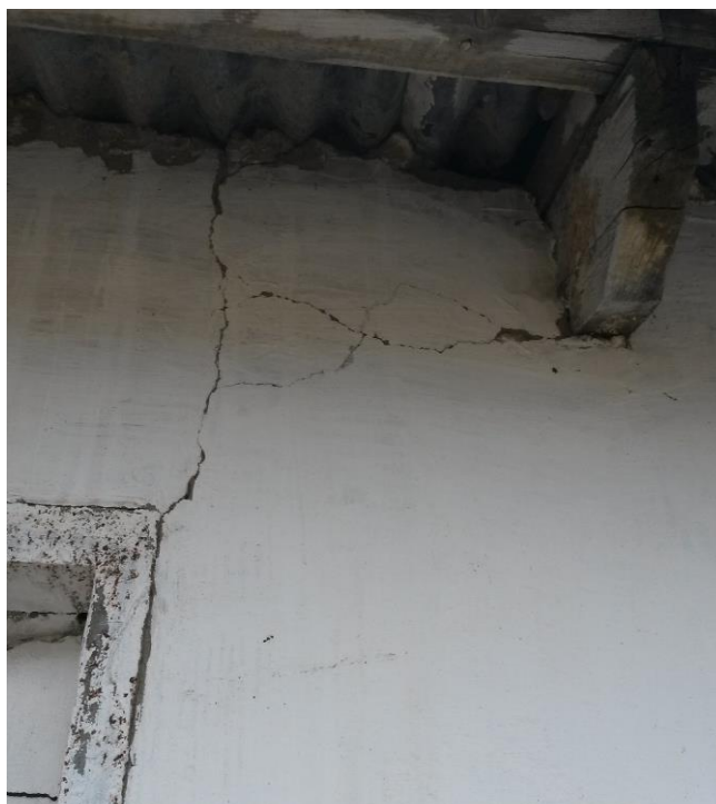
Obr. 20: Porucha č.2 – Popraskaná omítka
