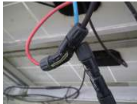
Obrázek 2.4. Konektory poškozené nadměrným zahřátím.
