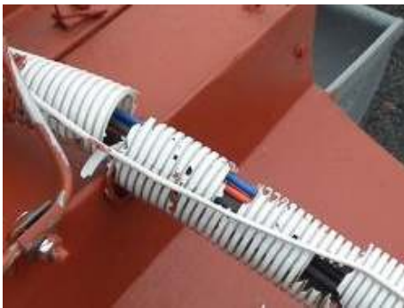
Obrázek 2.3. Poškozená ochrana kabelů vlivem UV záření.
