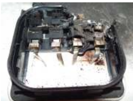
Obrázek 2.5. Celkové poškození junction boxu vlivem nadměrného zahřátí.
