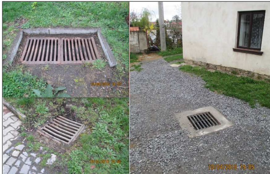
Obrázek 19 Vpusti dešťové kanalizace v obci Svojšice [Zdroj: vlastní]
