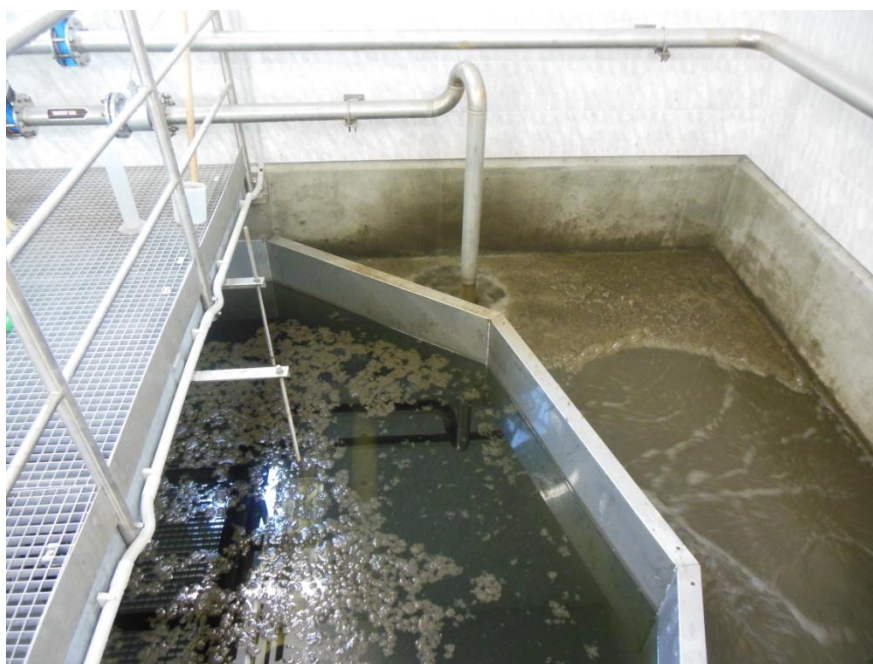
Obrázek 4.3: Čerpání vratného kalu z dosazovací do směšovací nádrže
