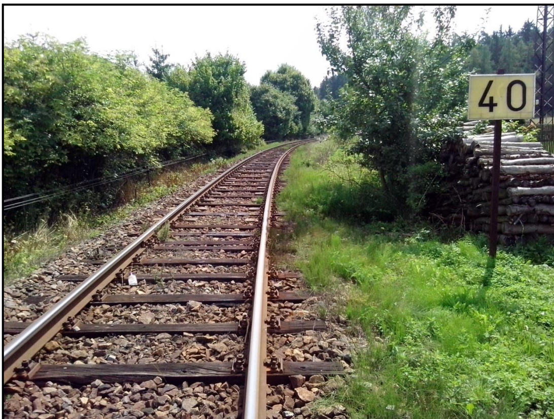
Obrázek 1.15: Nejvýraznější omezení na trati - snížení rychlosti na 40 km/h před úrovněm přejezdem zabezpečeným pouze výstražným křížem
