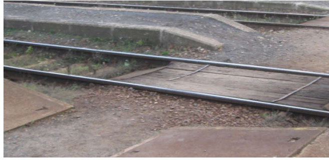
obr. č. 13 Výškový rozdíl způsobený rozdílnou výškovou polohou kolejnice a okolní plochy [Zdroj: Autor]
