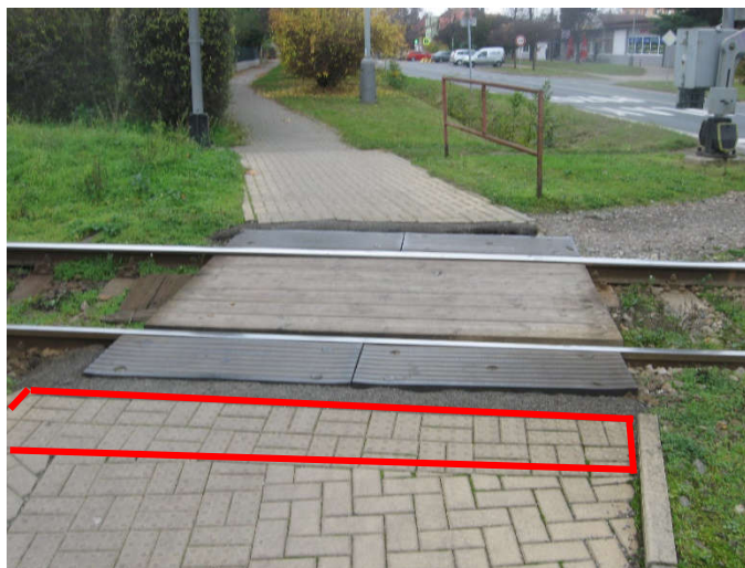
obr. č. 54 Chybně umístěný varovný pás na železničním přejezdu v ulici Kbelská vlevo, ve směru do centra. [Zdroj: Autor]
