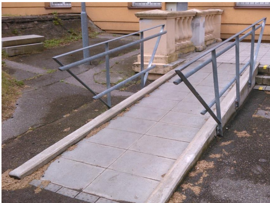
Obrázek 66 - Rampa se zábradlím, které není po celé její délce [foto Jan Matoušek]
