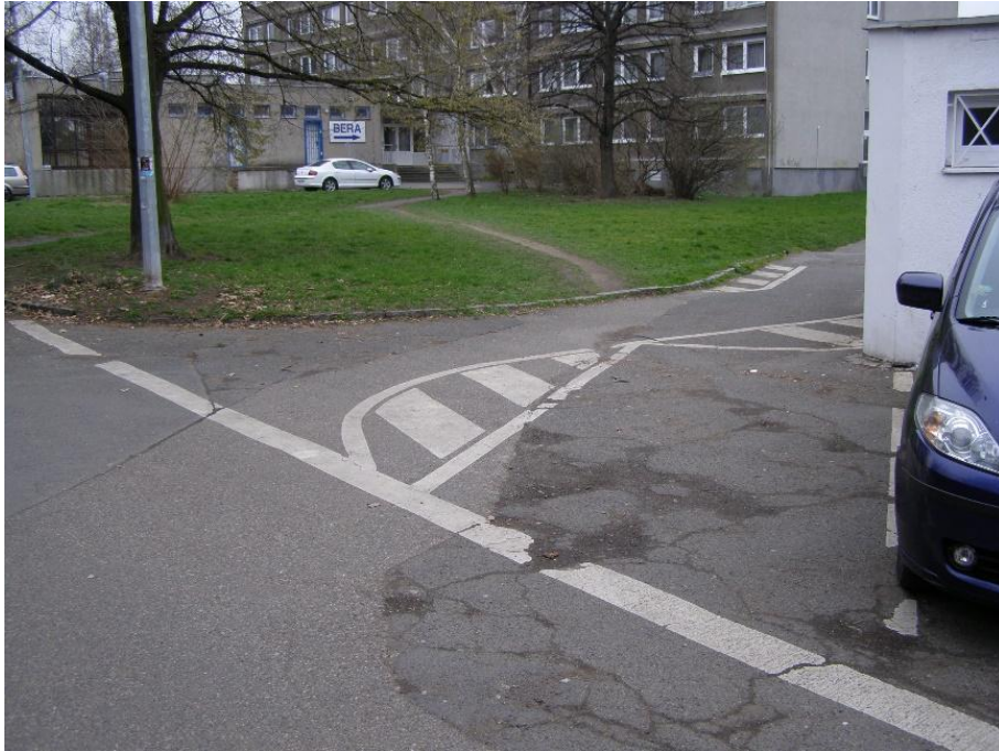
Obrázek 19 - Příklad povrchu s malou četností poruch [foto Jan Matoušek]
