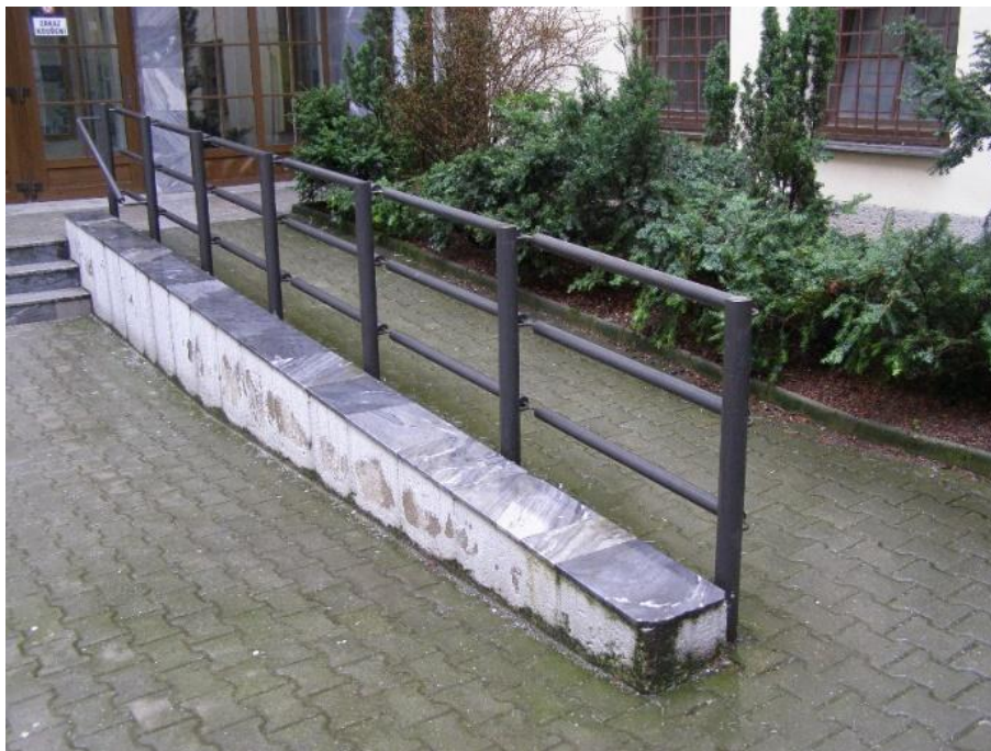
Obrázek 64 - Rampa se spodní podestou nevyhraničenou vůči navazující komunikaci pro pěší [foto Jan Matoušek]
