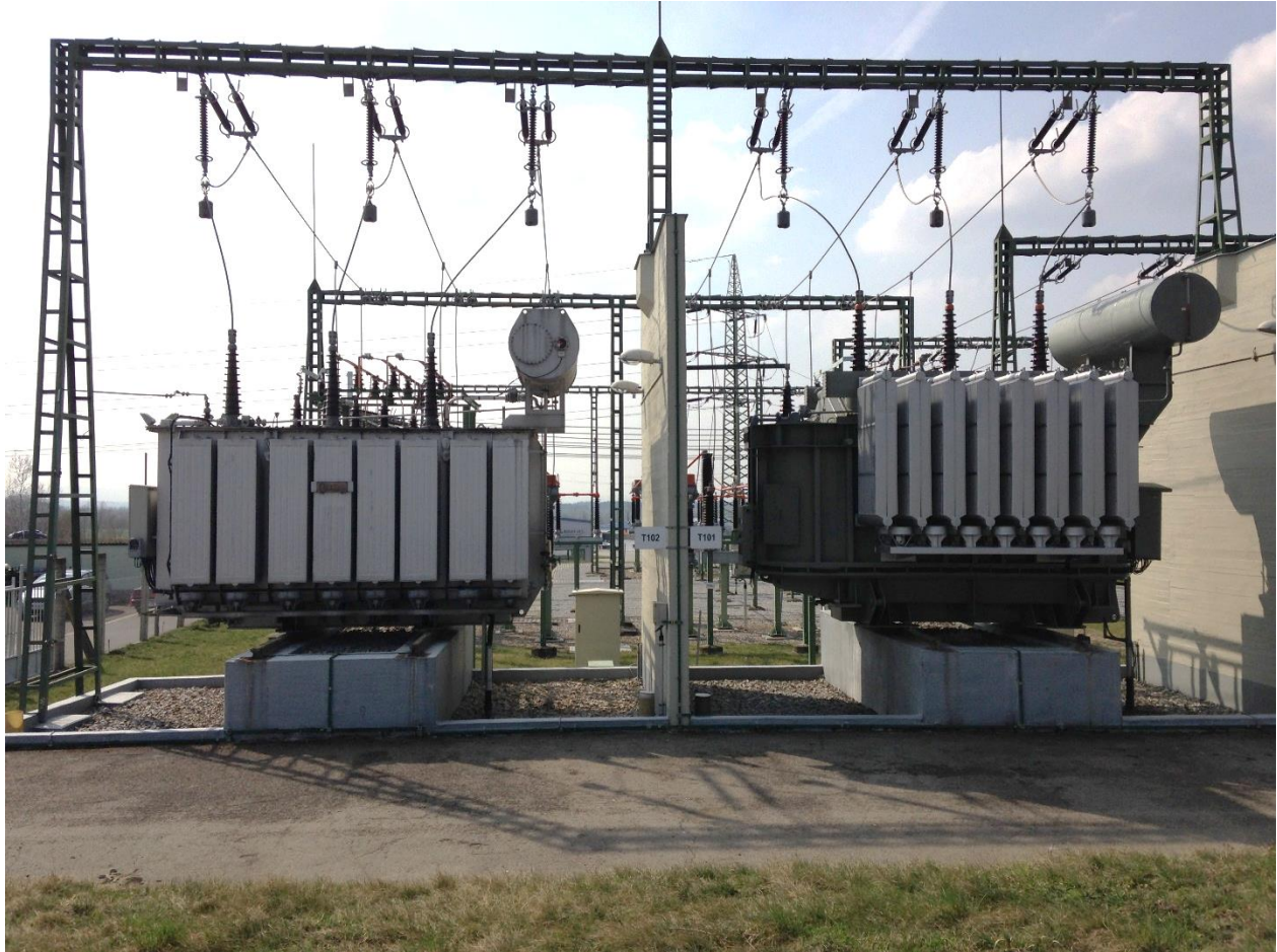
Obr. 9 – Transformační stanice 110/22kV Písek-Čížovská
