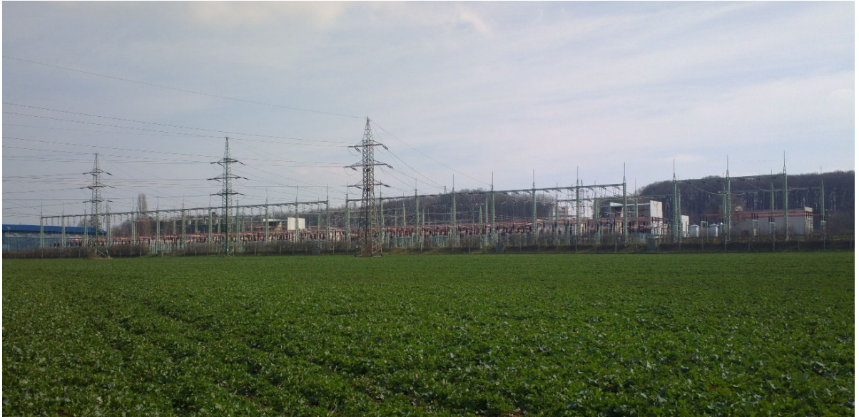
Obr. 5.7 Pohled na dnešní rozvodnu TR Sever 123 kV
