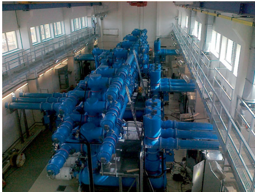
Obr. 5.22 Zapouzdřená rozvodna 420 kV Chotějovice [37]
