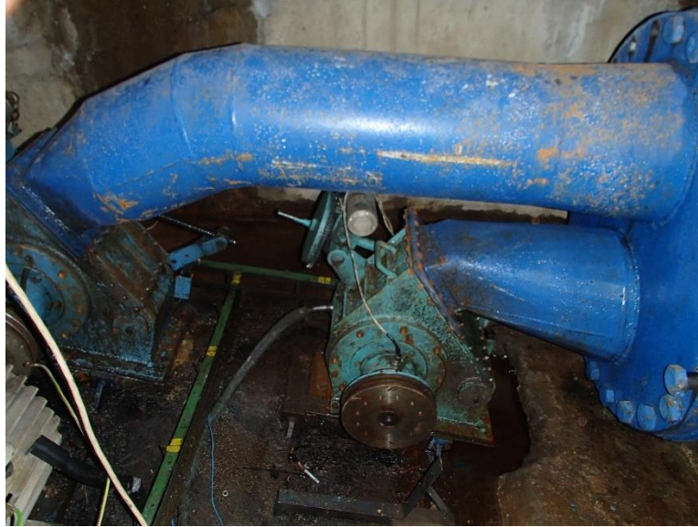
Obr. 5 Stav elektrárny před rekonstrukcí (jeden generátor již odpojen)
