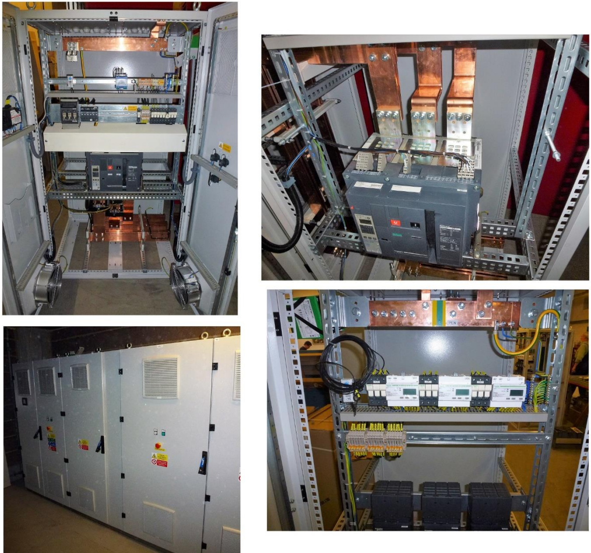
Obrázek 1 Hlavní rozváděč RH, 9 polí, I_n=1200A , detaily polí rozváděče a pohled na řadu polí
