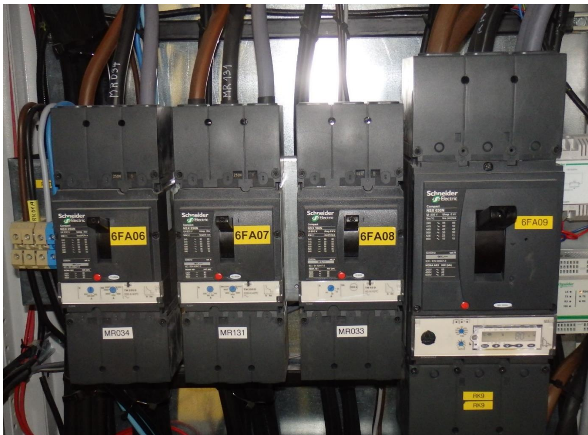
Obrázek 25 Výkonové jističe v rozváděči RHS2, 6. pole
