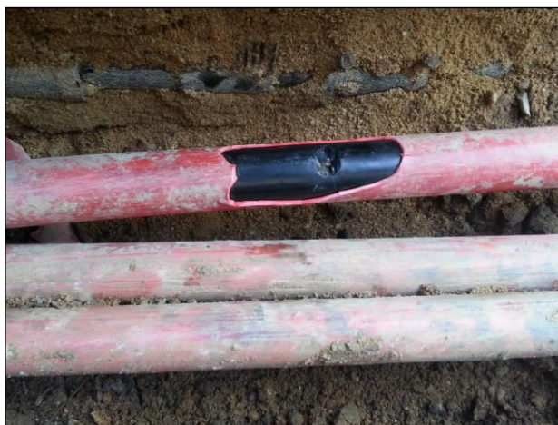
Obrázek 10: Poškození kabelu AXEKVCEY
