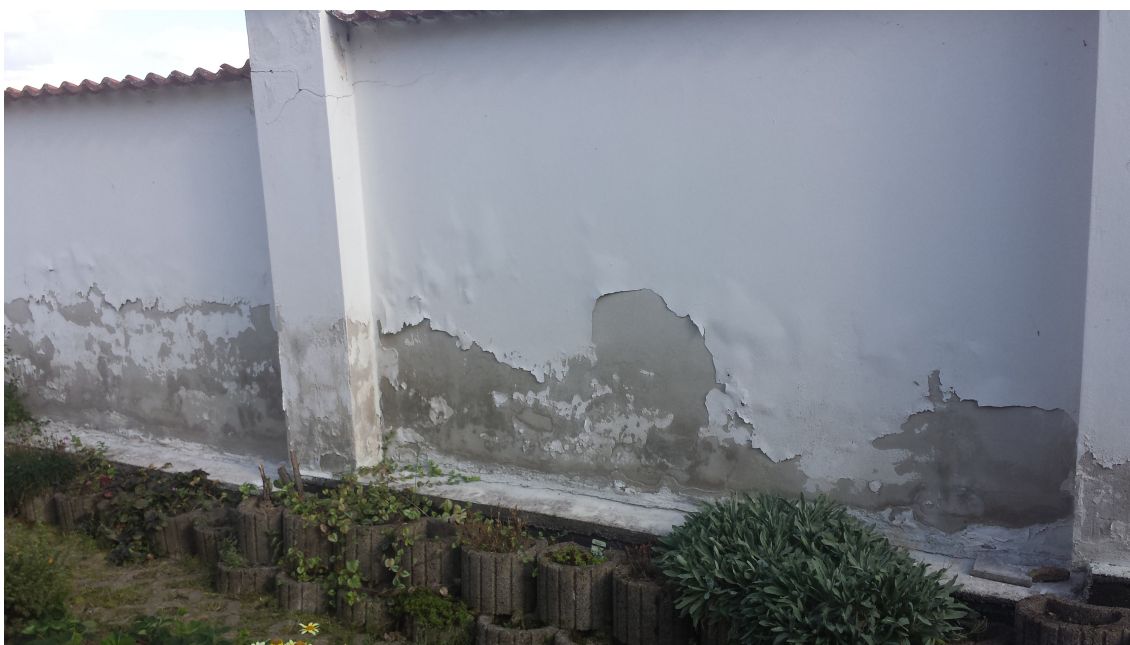
fotografie č. 13,14 – ukázka špatně provedené hydroizolace
