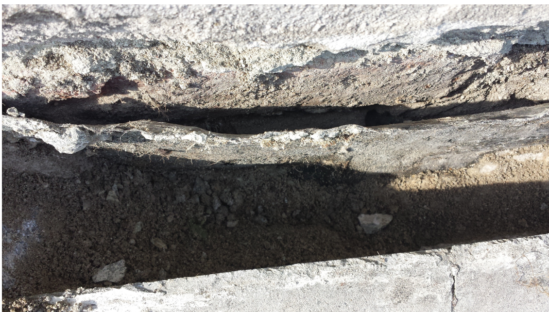
fotografie č. 15,16 – ukázka špatně provedené svislé živičné hydroizolace, odtržení od základu, špatně provedená penetrace.
