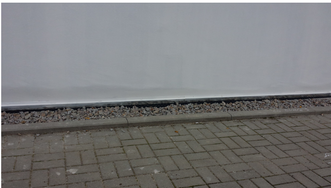
fotografie č. 17,18 – stav po opravě, svislé navaření živичné lepenky + penetrační nátěr, provedení nopové izolace s geotextilií, odvodnění za pomoci flexibilní trubky se zásypem šterku frakce 16-32.
