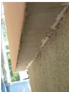
Obrázek 15 Špatné založení první vrstvy[13]
