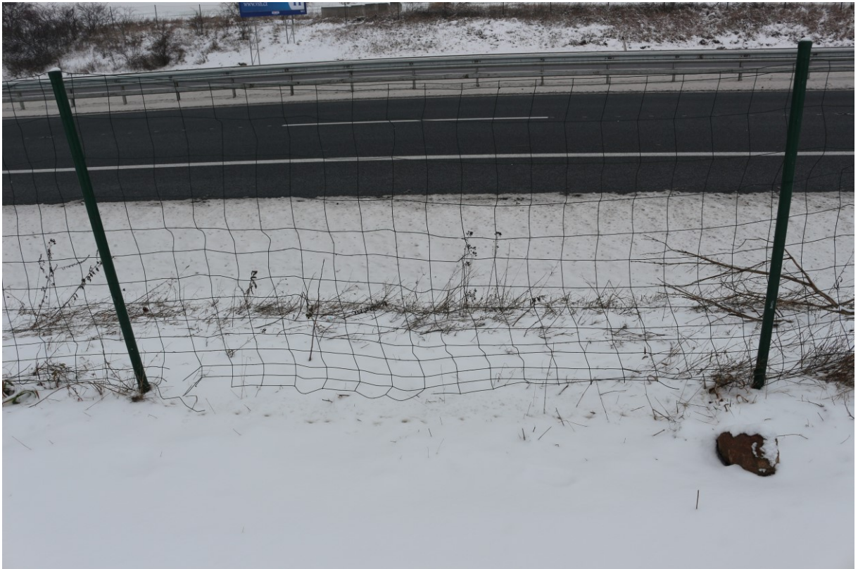
Oplocení D11 – poplastované dle předchozích PPK – PLO, poškozené
