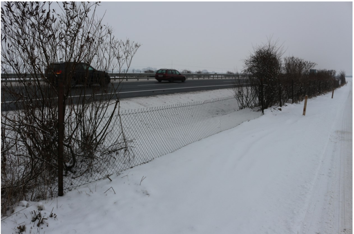
Oplocení D11 – mezera doplněna nevyhovujícím pletivem, po pravé straně pozůstatky pachového ohradníku, pletivo prorostlé vegetací
