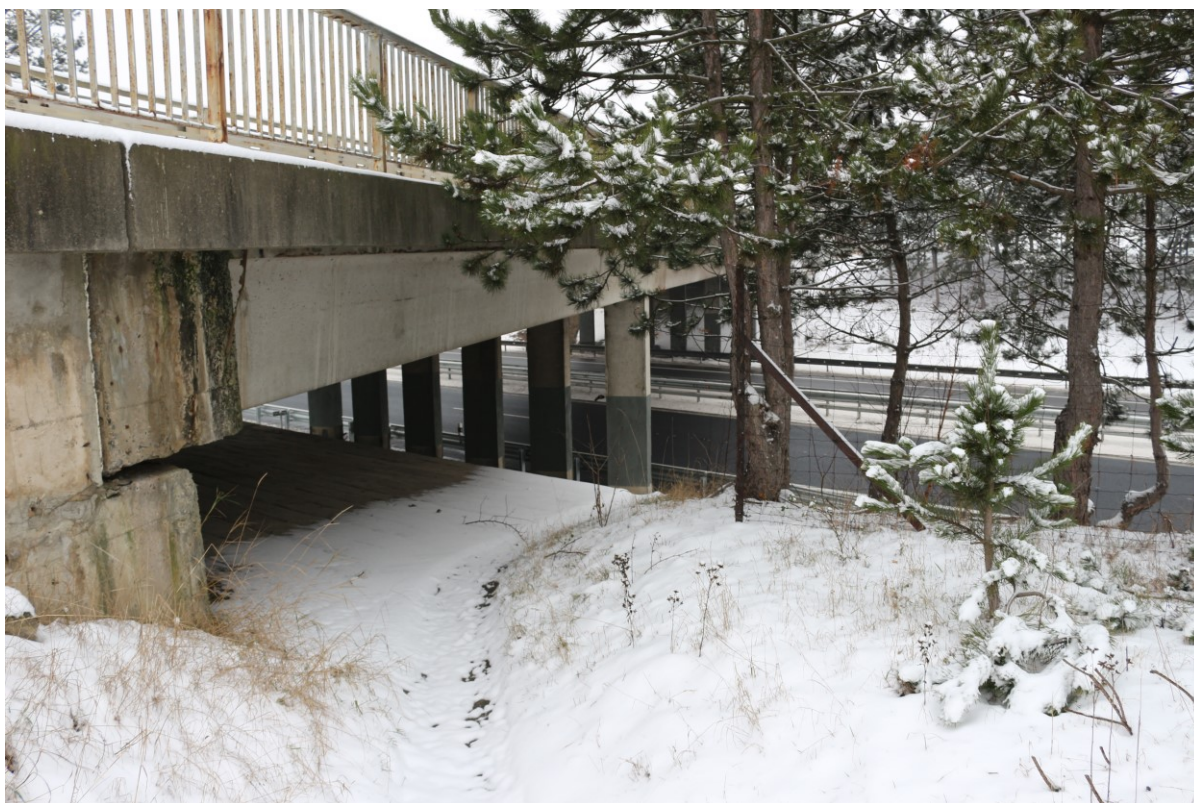
Oplocení D11 – velmi zastarale, chybně nedotažené k mostnímu objektu.
