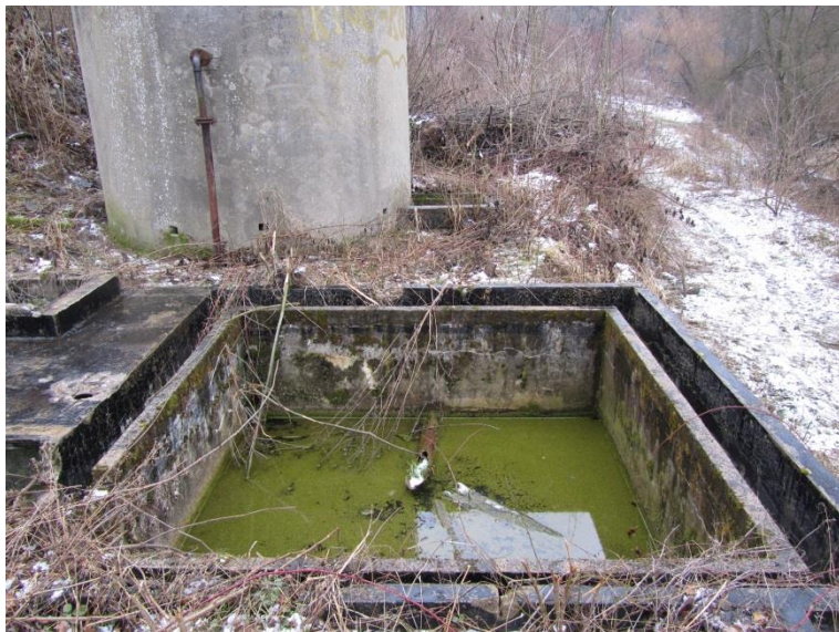
Obr. 4.22 – Dosazovací nádrž s přítokovým potrubím
