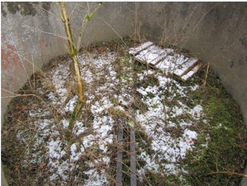
Obr. 4.21 – Pohled do rychlofítru – zkrápěcí zařízení
