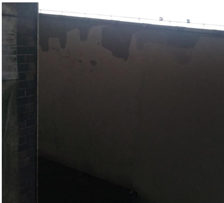
Obrázek 13 - budova Emauzy - objekt B - vlhkost budovy (foto autorky)
