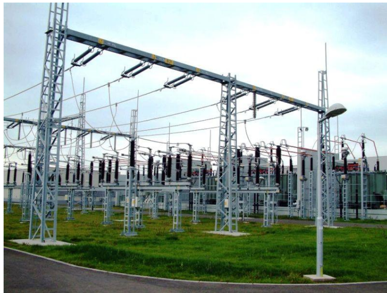
Obr. 2: Rozvodna (ČEZ, a.s.)
