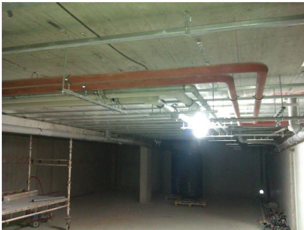
Obrázek 25 - ukáзка potrubního vedení v bytovém domě, zdroj: autor
