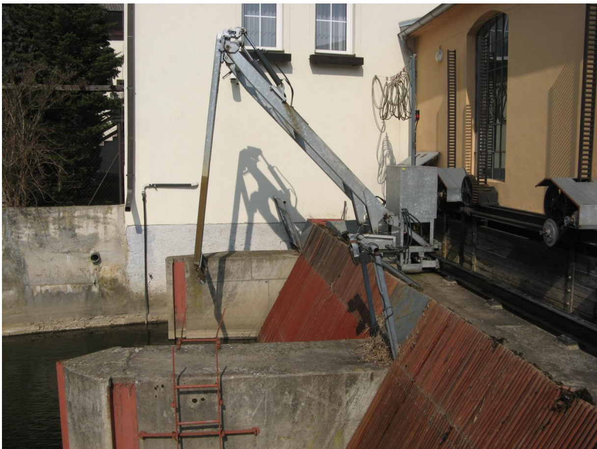
Obr. 3.1-1: Stávající jemné česle a jejich čistící zařízení [16]
