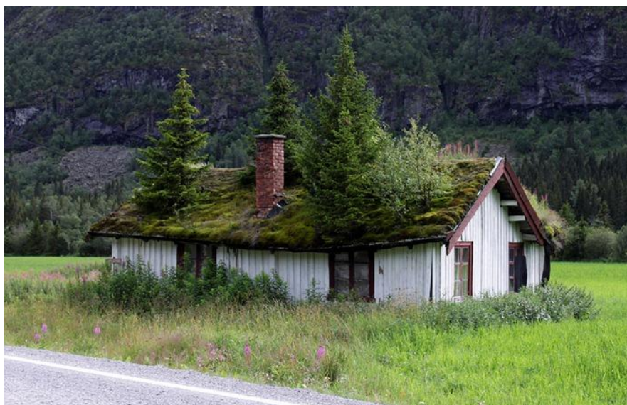
Obr. 8: Neudržovaná střecha v Norsku [11]
