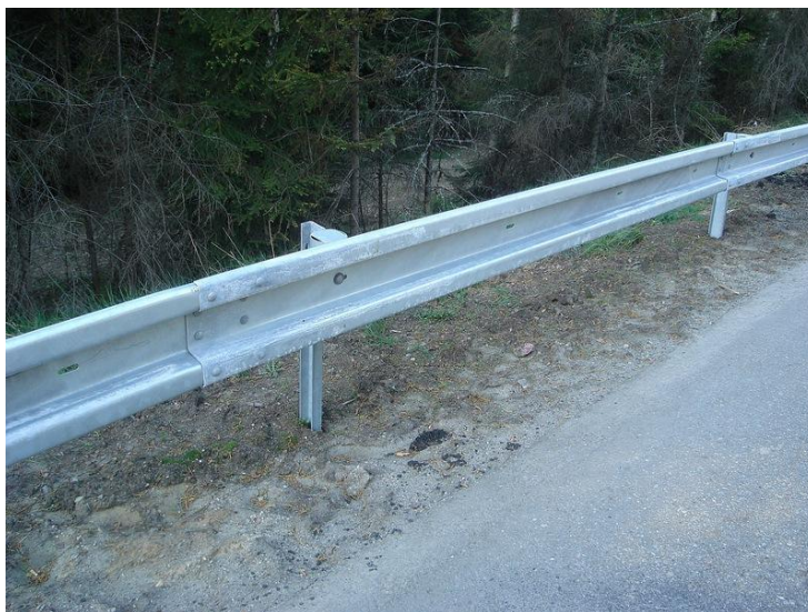
Obrázek 24: Jednostranné sloupcové ocelové svodidlo
