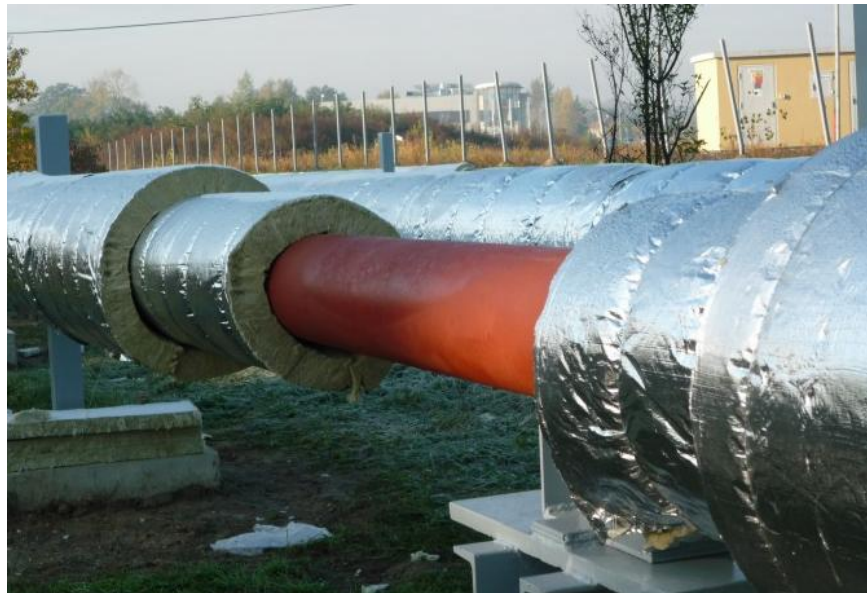
Obrázek 11: Ocelové potrubí s izolací.
