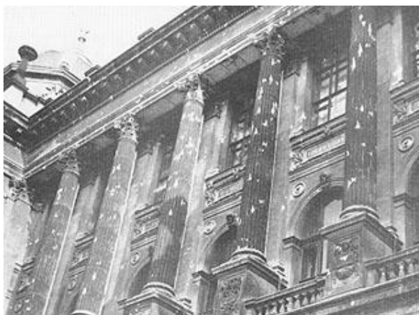
Obr. 4: Poškození fasády při střelbě z kulometů a samopalů 22. května 1968 [16]
