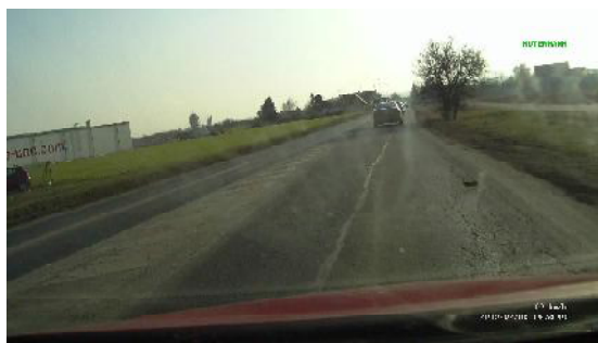
Obrázek 5.13: Špatný stav vozovky v ulici Pražská
