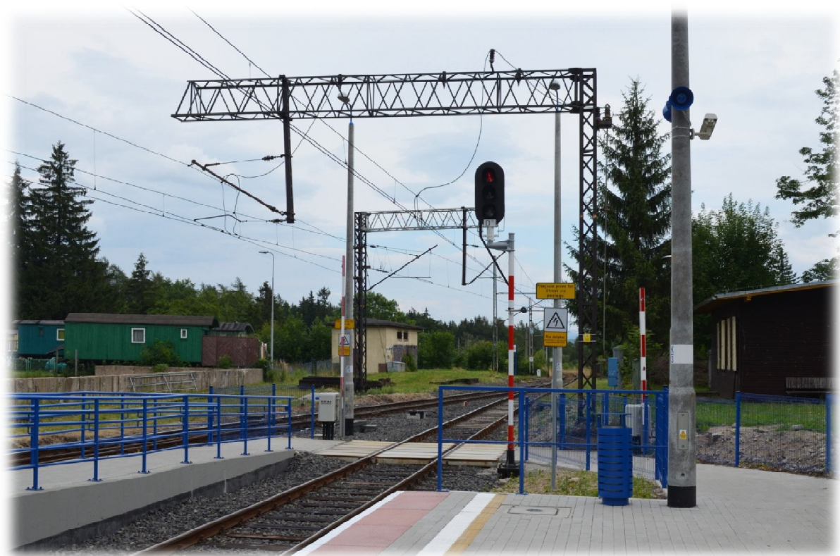
Obrázek 56.: Přejech na jednostranné nástupiště vybavený závorami. Szklarska Poręba Górna 2014.
