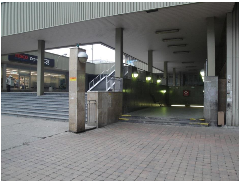
Obrázek 8 - Východ z vestibulu metra do ulice Kischova, na obrázku jsou vidět zbytečné 2 schody.
