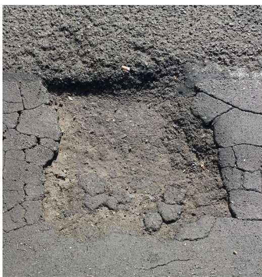
Obrázek 17 - Výtluk v opravené části původní závady
