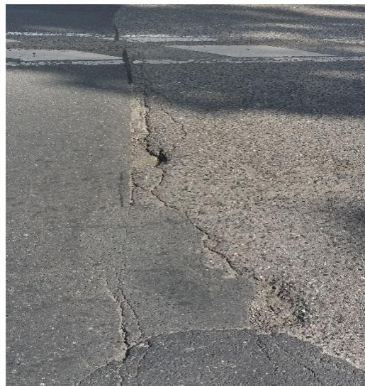
Obrázek 15 – Trhlina v povrchu vozovky
