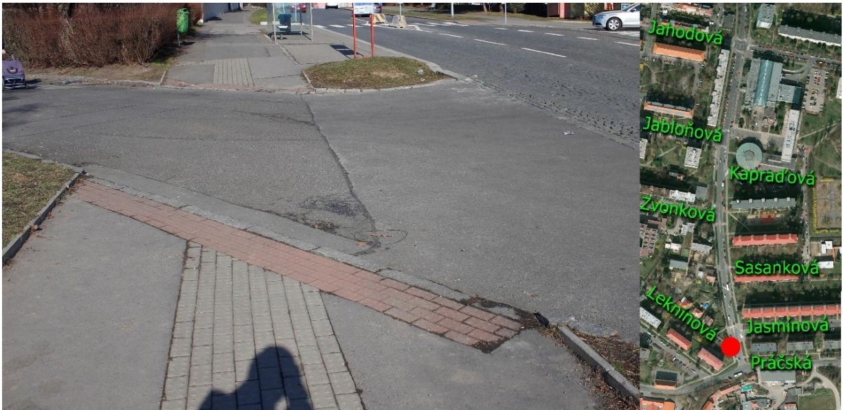
Obrázek 11 Špatné provedení hmatových prvků (zdroj: Autor, [21])
