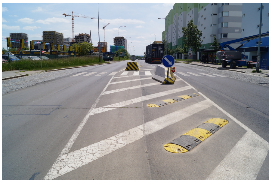
Obrázek 11.5: Stávající nevhodně provedený a umístěný přechod pro chodce
