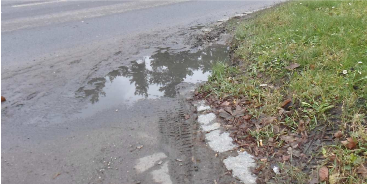
Obr. 6 Hromadění vody na komunikaci
