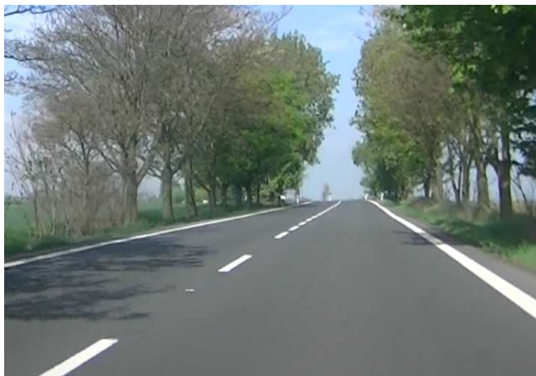
Obrázek 71 - Nesoulad směrového a výškového vedení
