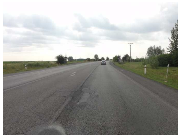
Obrázek 54 - Opotřebované VDZ v křižovatce
