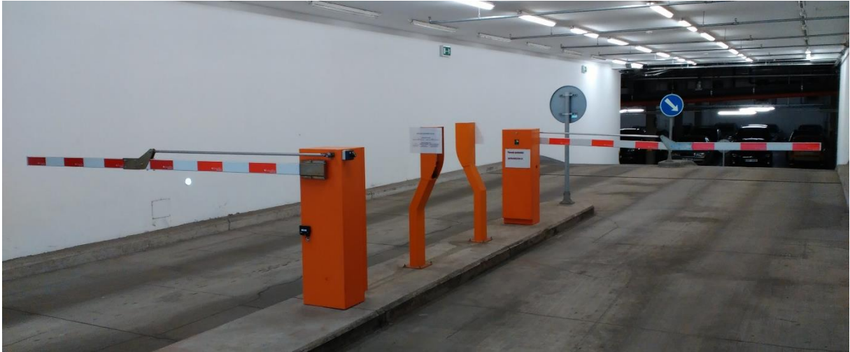
Obr. 27: Závory ve vjezdovém koridoru do podzemních garáží, čtečky pro jejich ovládání jsou umístěny na sloupcích uprostřed snímku (foto: autor)
