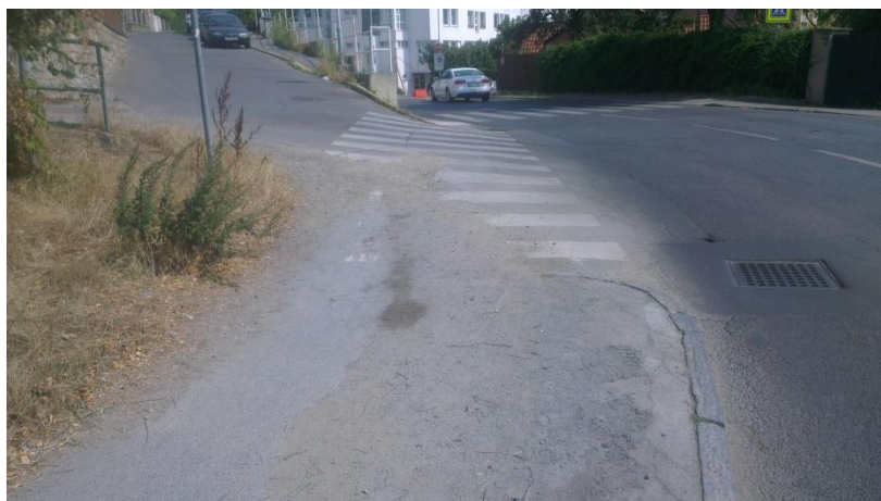
Obr. 71: Poničený prvek chodníku a zničený obrubník (zdroj: David Petr)
