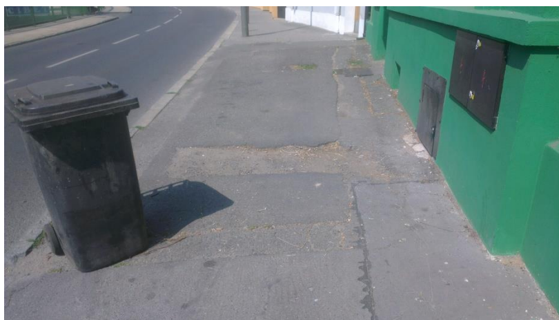
Obr. 72: Poničený povrch chodníku (zdroj: David Petr)
