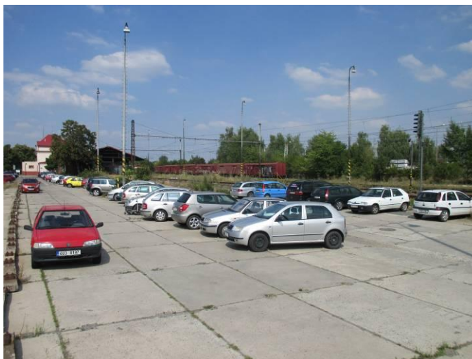
Obrázek 11: Panelová plocha parkoviště Čelákovice, foto: D. Koubek
