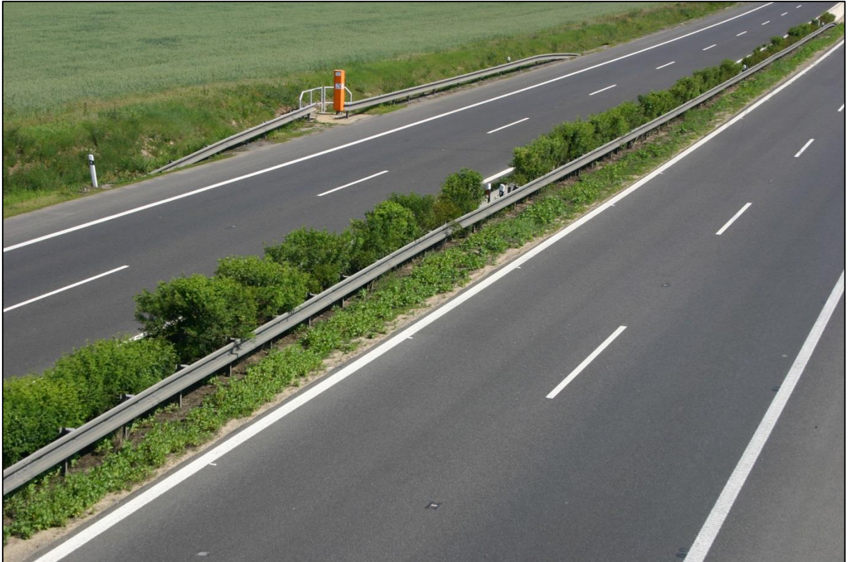
Obrázek 2: Vegetace jako clona proti oslňování od protijedoucích vozidel na dálnici D8 v km 13,8. [15]
