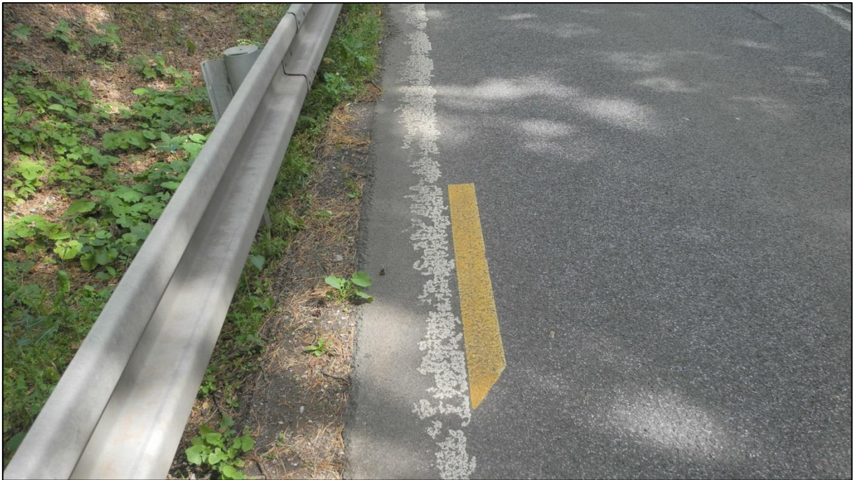
Obrázek 11: Zbytek provizorního vodorovného dopravního značení.
