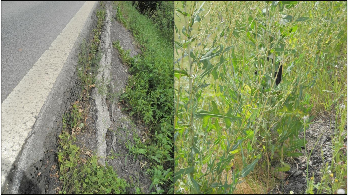
Obrázek 16: Nalevo je rozpadající se krajnice, napravo je zarostlý směrový sloupek.
