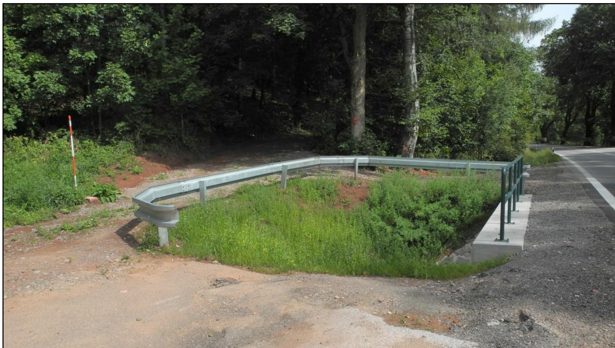
Obrázek 14: Nesprávné provedení svodidla typu JSEM-4/N2.
