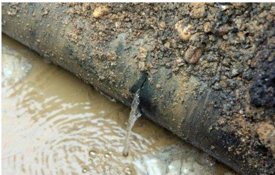
Obr. 2.4 - Prasklina na vodovodním řadu [24]
