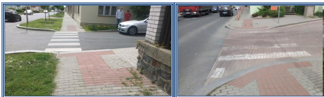
Obr. 21: Nesprávné provedení přechodů pro chodce
