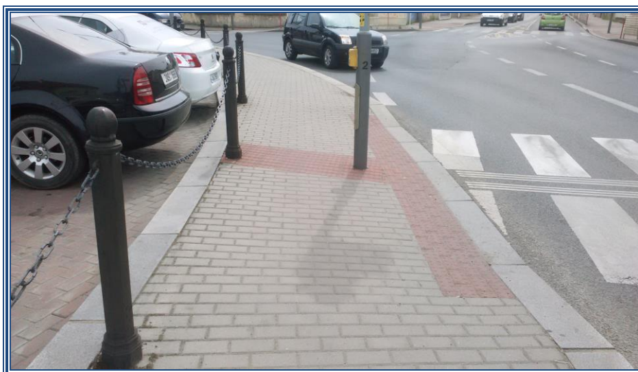
Obr. 23: Nesprávné provedení signálního pásu
