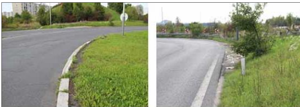
Obrázek 36: Chlumecká ulice - rozrušená krajnice [27]
