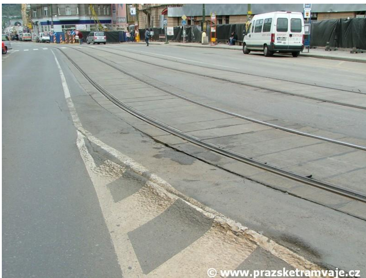
Obrázek č. 5. Deformace vozovky na vnější části oblouku [4]
